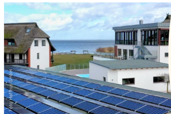
Eine Photovoltaik-Anlage deckt den Strombedarf des Haffhus Ueckermünde.
